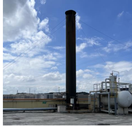
30TH 锅炉废气排放口 DA025
