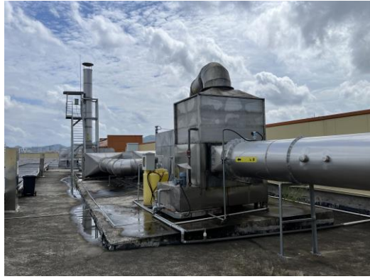
31TH 化成栋有机废气排放口 DA021
