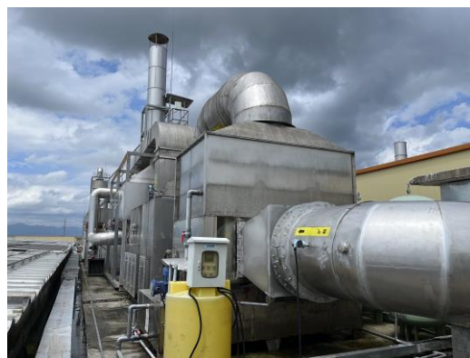
31TH 电芯栋有机废气排放口 DA018
