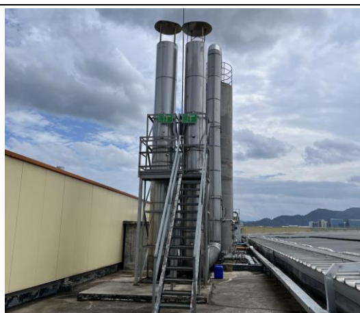
31TH 正极 NMP 废气排放口 DA019（右边排气筒）、31TH 负极 NMP 废气排放口 DA020（左边排气筒）
